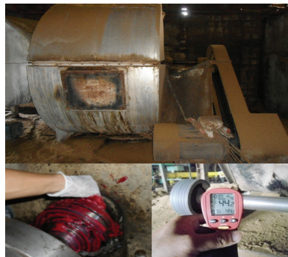
锅炉机组的引风机和光纤鼓风机组
