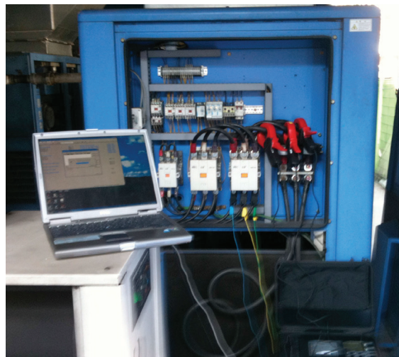
该记录仪在客户现场检查空气压缩机的电耗
